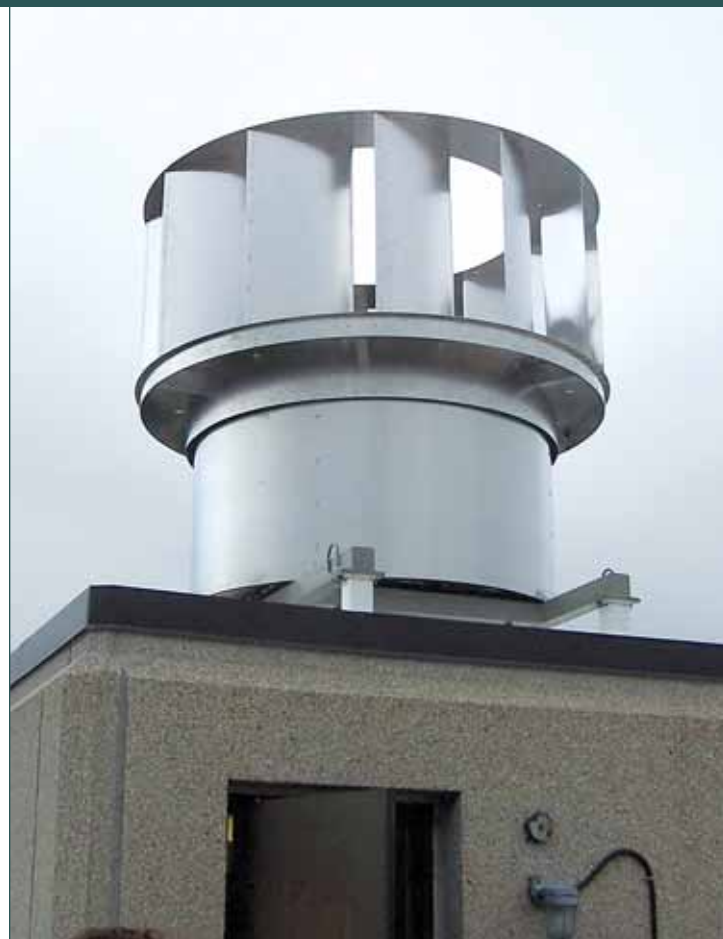
Une éolienne installée au Cégep de Sorel-Tracy par Turbines éoliennes Vertica
